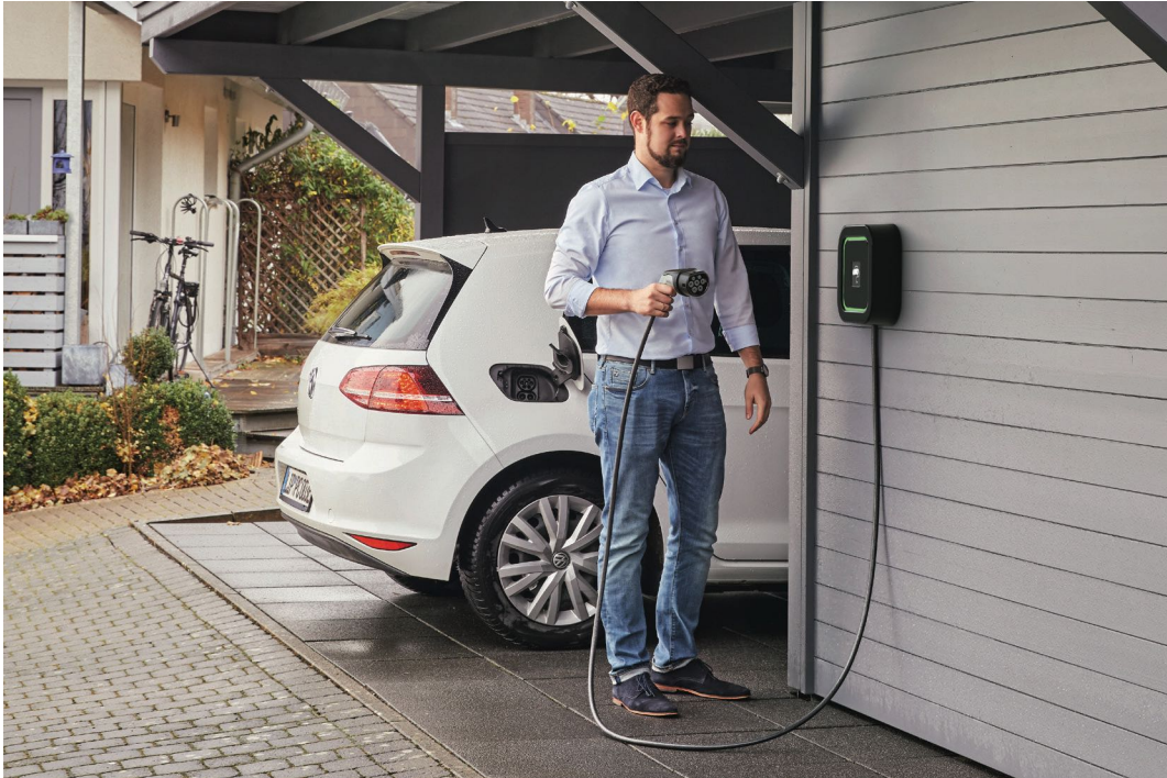
Bild 2: Ladeeinrichtung für Elektrofahrzeuge auf einem privaten Grundstück
