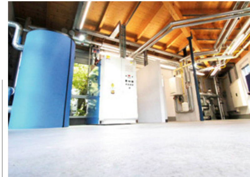
DIE HEIZZENTRALE DER STADTWERKE WAIBLINGEN.
