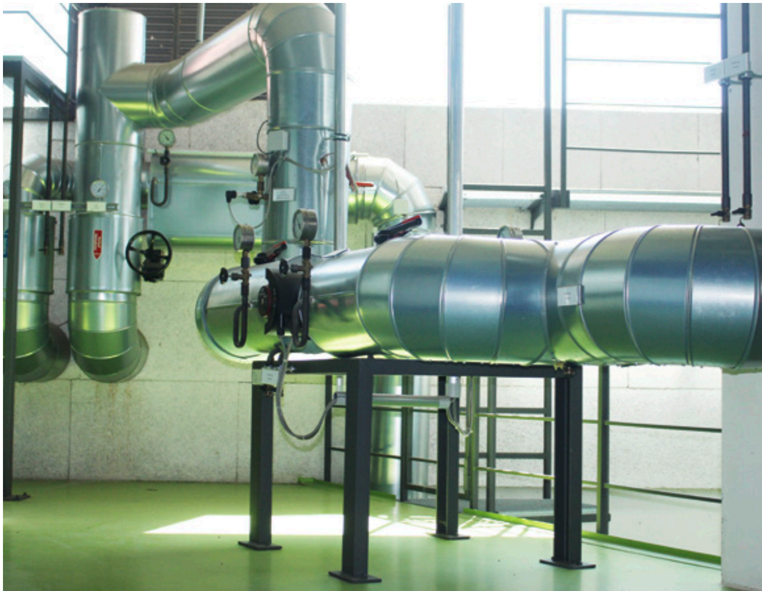
DER AUSBAU DER WÄRMEVERSORGUNG WIRD KONSEQUENT FORTGESETZT
